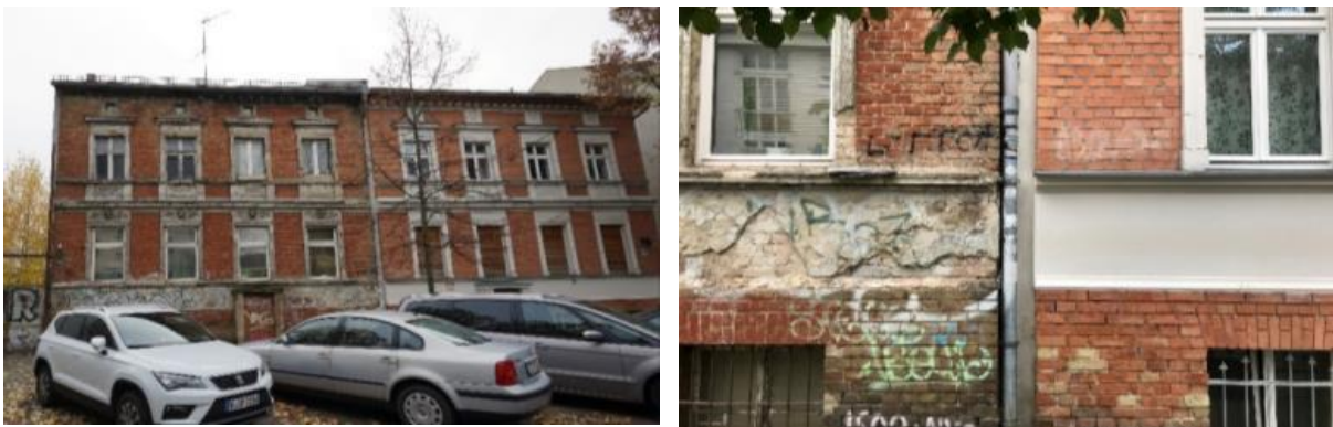
Abbildung 27: Das Nebeneinander von kürzlich saniert und stark sanierungsbedürftig im Untersuchungsgebiet, Behaimstraße 48 und 50
